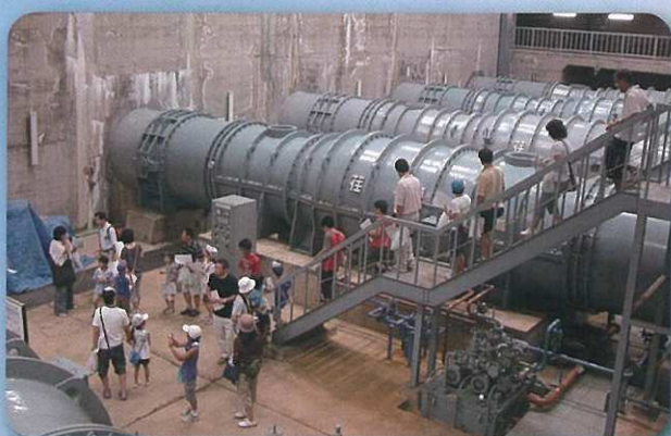
排水ポンプの見学
